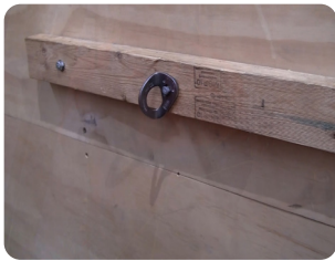
Punto di ancoraggio a parete
